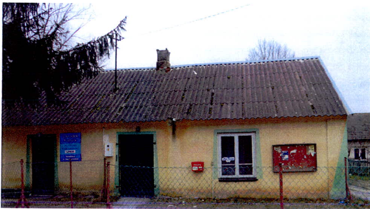
Zdjęcie nr 3: Budynek Świetlicy Wiejskiej w Dacharzewie Fot: GRACZKOWSKI DOTACJE Sp. z o.o. styczeń 2015r.
